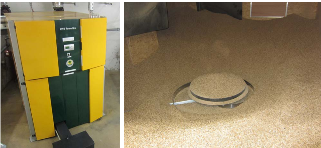
Abb. 1: Pelletheizkessel und Pelletsilo mit Rührwerksaustragung
