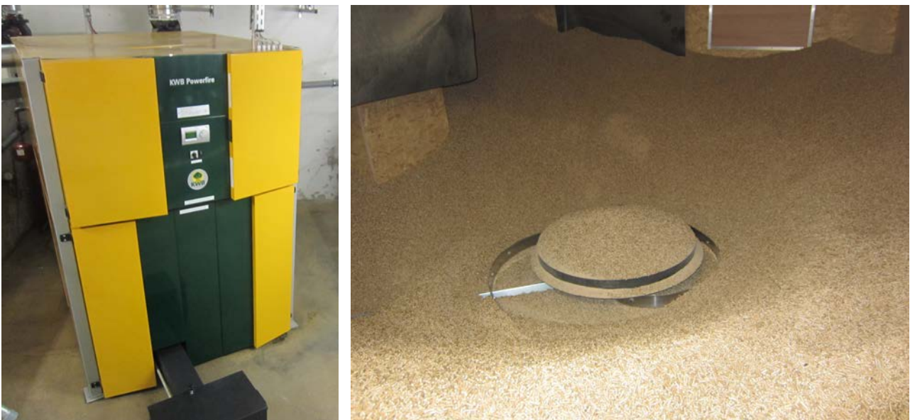
Abb. 1: Pelletheizkessel und Pelletsilo mit Rührwerksaustragung
