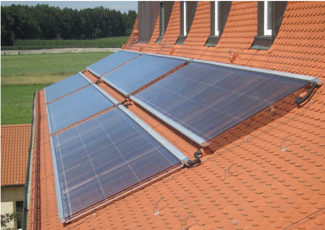
Abb. 2: Kollektorfeld mit 600 Vakuumröhren
